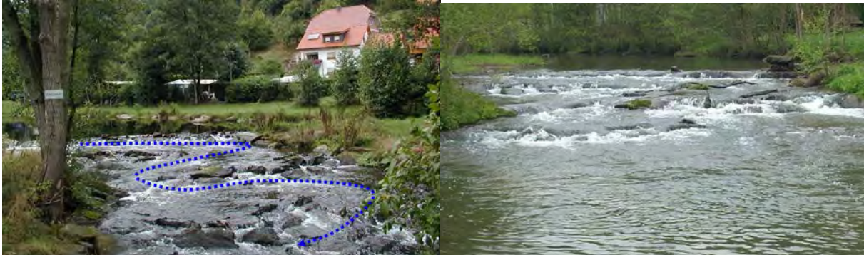
Ehem. Inselwehr kurz nach dem Umbau und heute. Serpentinartige Anordnung der Riegel.
